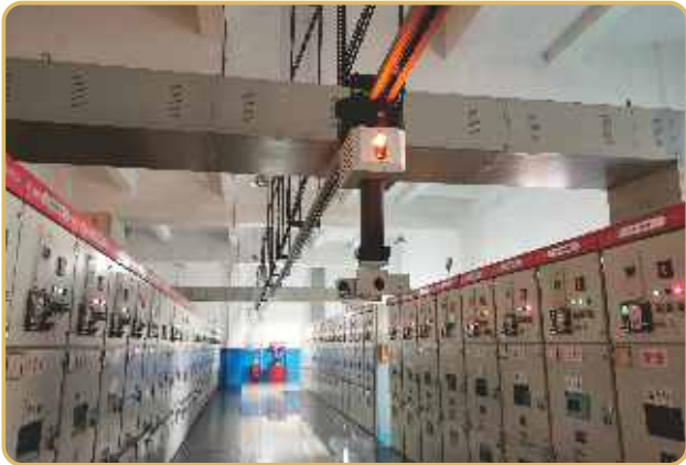
电力公司引进智能巡检机器人
